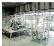
図3/30kW海洋温度差発電装置
